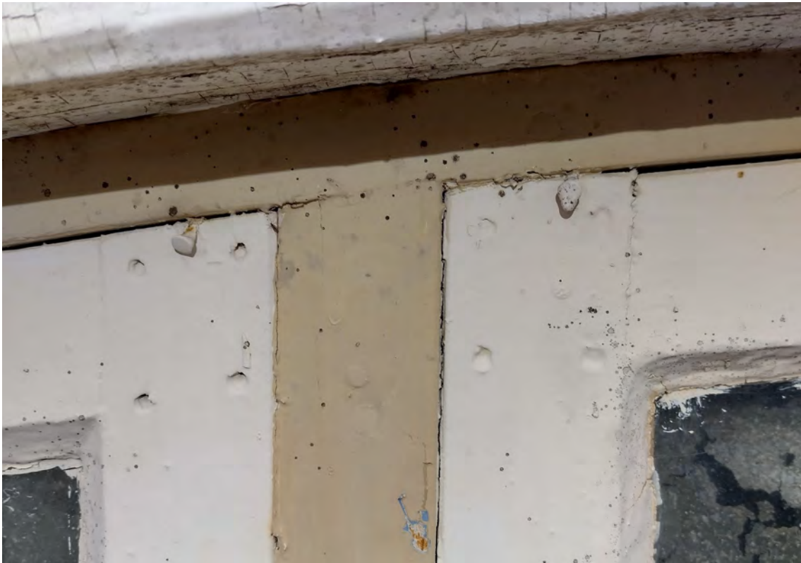
Kuva 3: Pohjoisoven päällä olevien ikkunoiden liitoksia.
