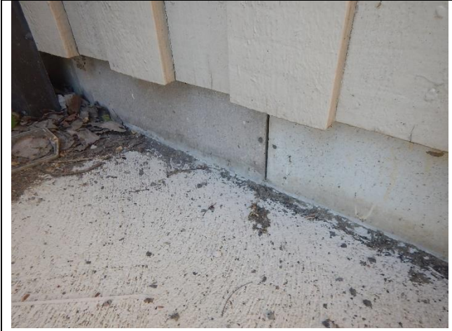
Kuva 1. Julkisivun asbestipitoinen sementtilevy.
