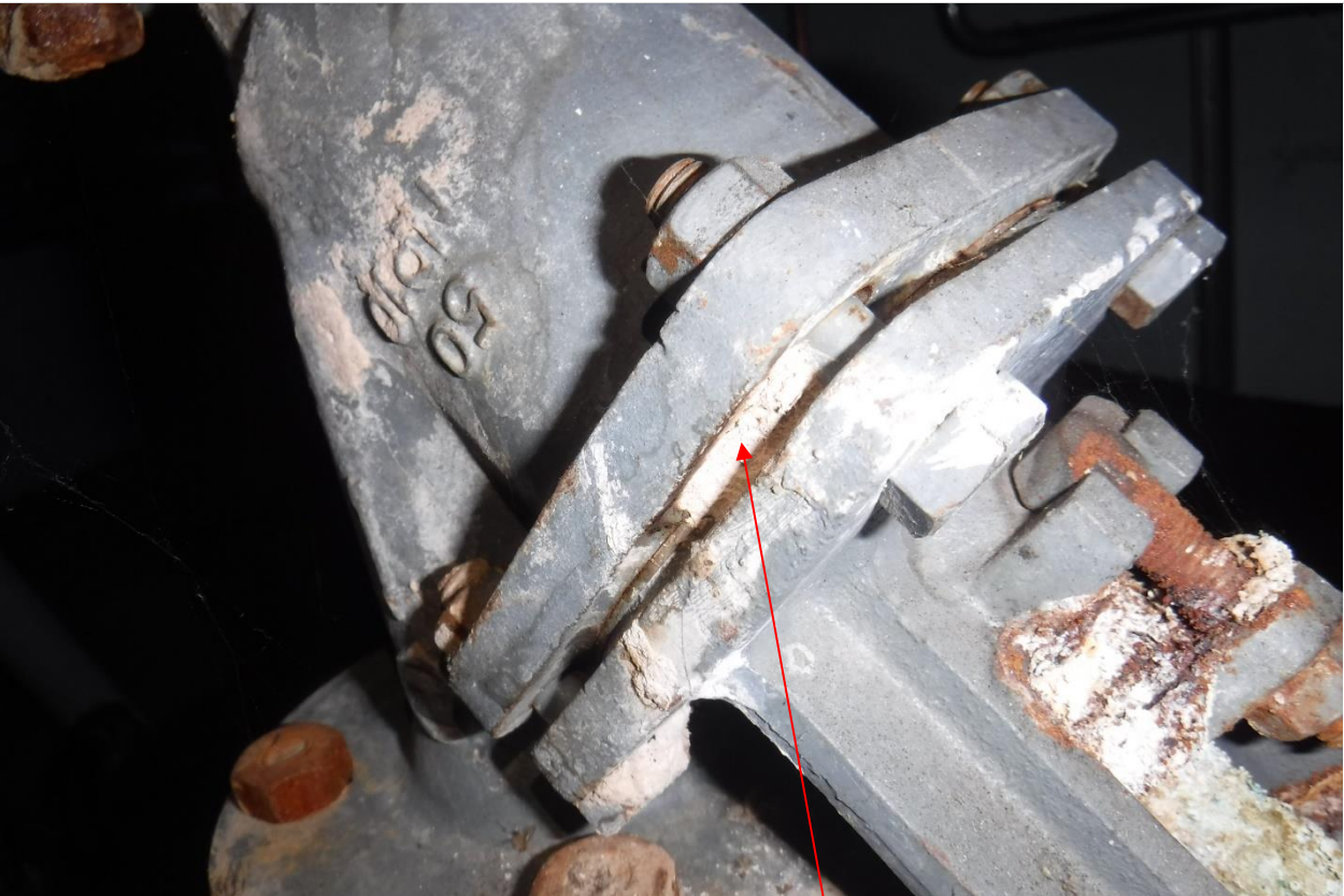
Lämmönjakuhuoneen putkien laippaliitoksissa asbestipitoisen eristeen jäämiä.
