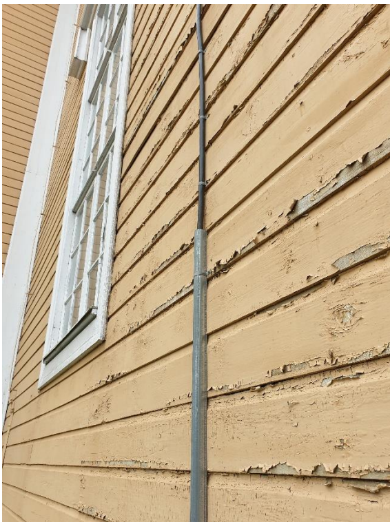
Kuva - Maalipinta paikoin erittäin huonokuntoinen
