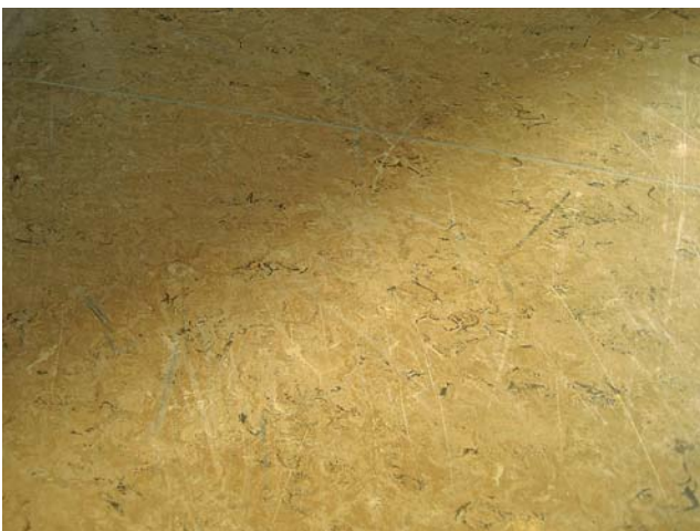
Kuva 5. Lattia, ei täytä mitään puhtaustasoa.
