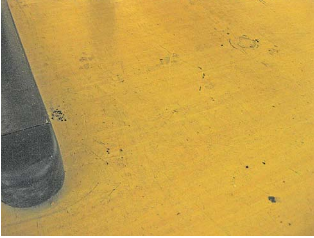
Kuva 1. Kokoustilan lattia, ei täytä mitään puhtaustasoa.
