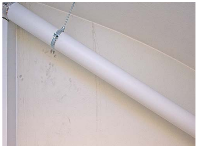
Kuva 6. Seinä, ei täytä mitään puhtaustasoa.
