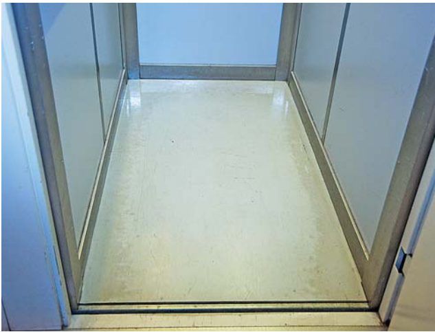
Kuva 9. Hissin lattia, ei täytä mitään puhtaustasoa.
