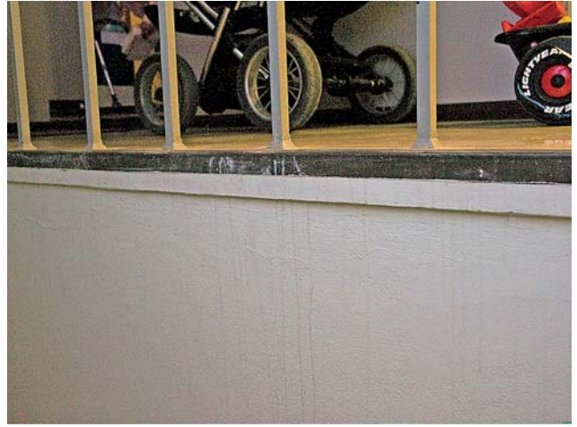
Kuva 8. Portaikon seinä, ei täytä mitään puhtaustasoa.
