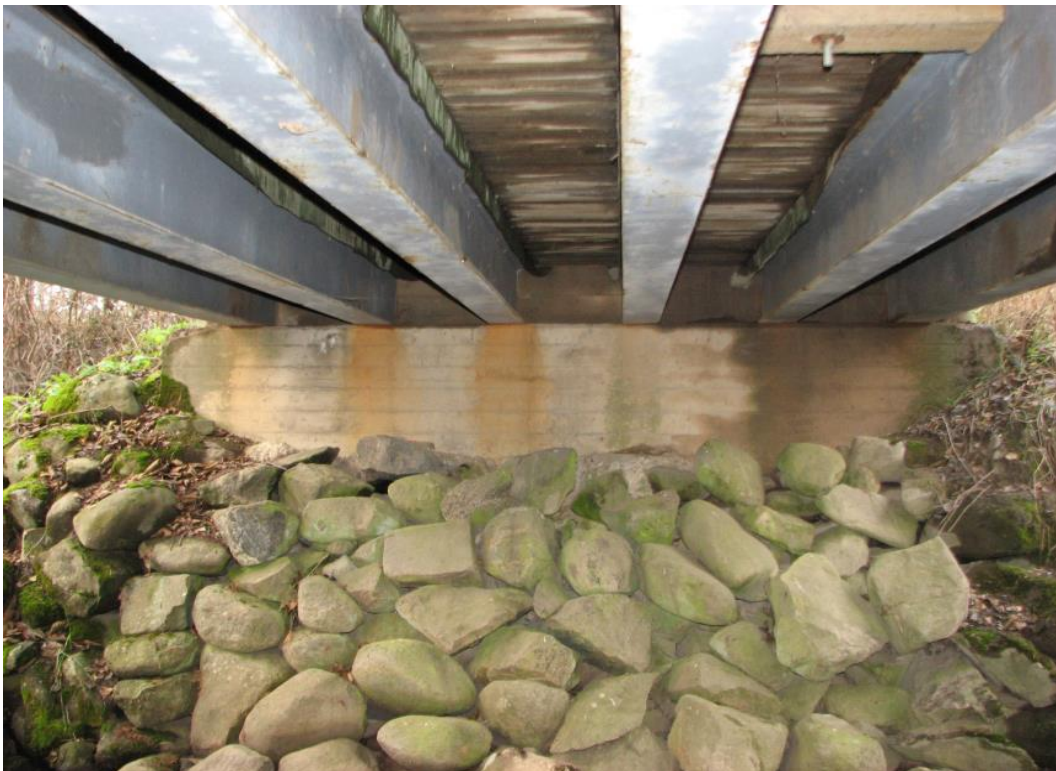
Näkymä kannen alle. Pääkannattajia on 6 kappaletta. Palkkien välillä ei ole jäykisteitä. Palkkien ja kannen välissä on huopakaistat.
