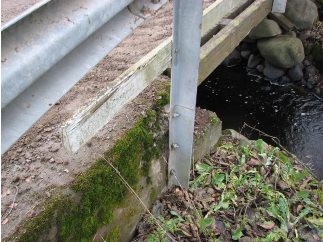
Rapautuma on vaurioittanut kaiteen kiinnityksen.
