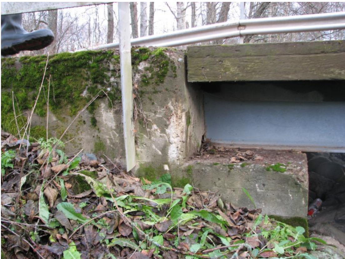
Maatuissa on verkkohalkeilua ja sammaloitumista.
