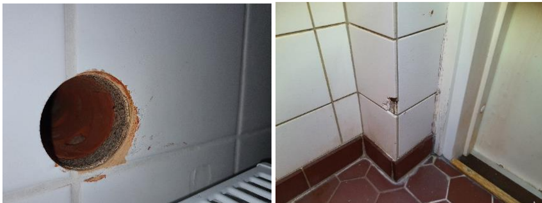
Kuva 12 – 13. B-talon pesulan ja pesuhuoneen seinälaatoituksia
