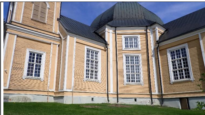
Eteläseinää: julkisivun keltainen ja valkoinen maali sekä ikkuna-maali
