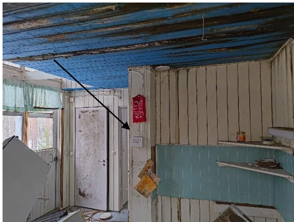
Kuva 2. Päärakennuksen alkuperäinen poistoilmahormi on mahdollisesti asbestipitoinen.
