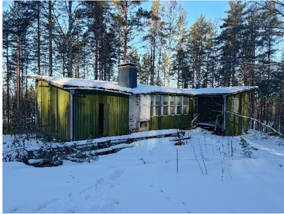
Kuva 1. Asbestipitoista bitumihuopaa päärakennuksen vesikatteena.
