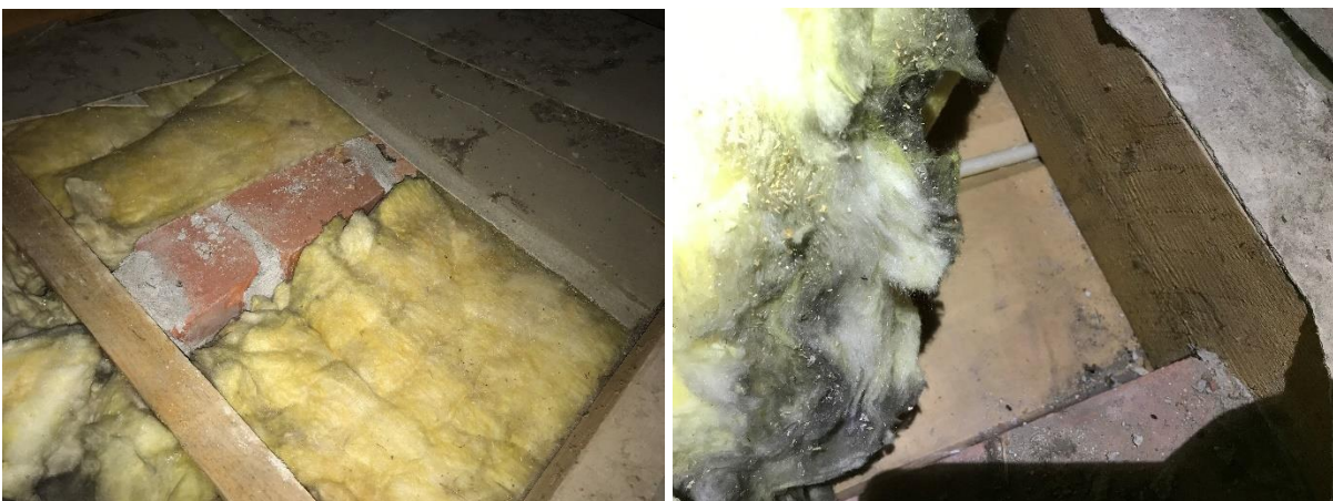
Kuvat 9a ja b. Tuulensuojalevyn alla lämmöneristekerroksessa oli havaittavissa melko runsaasti ilmavuotojälkiä. Vasemmassa kuvassa näkyy myös yläpohjan puuosien tukeutuminen tiiliväliseinään.
