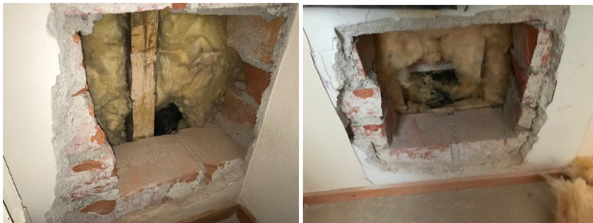
Kuvat 7a ja b. Ulkoseinän rakenneavaukset RA2 (vas. kuva) ja RA3 (oik. kuva).
