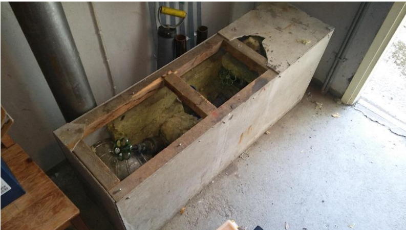
Asbestikuitusementtilevyä LJH:ssa, näyte 12.
