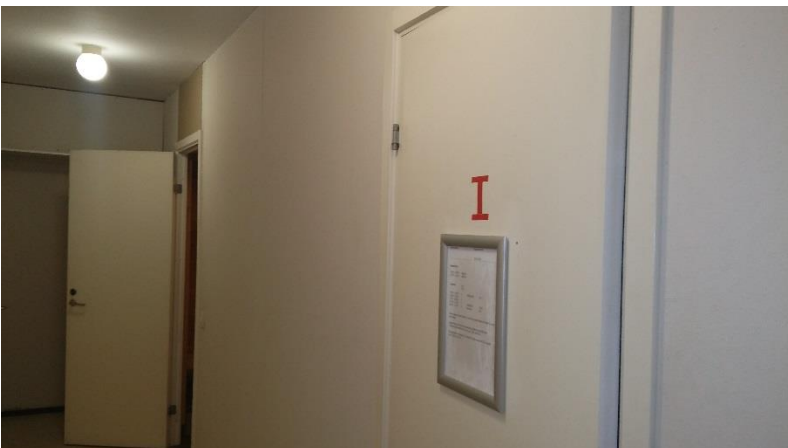
Asbestikuitusementtilevyä saunaosaston seinässä, näyte 12.
