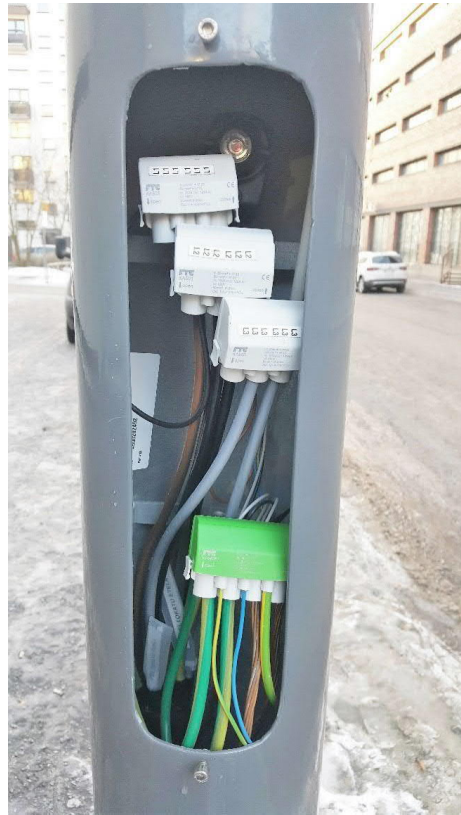
Kuva 6b. Valokuva pylvään kytkentätilan käytöstä.
