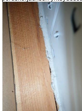
Kuva 6 Sähkötaulun takana on todennäköisesti asbestia sisältävä levy. Näytettä ei saatu otettua.
