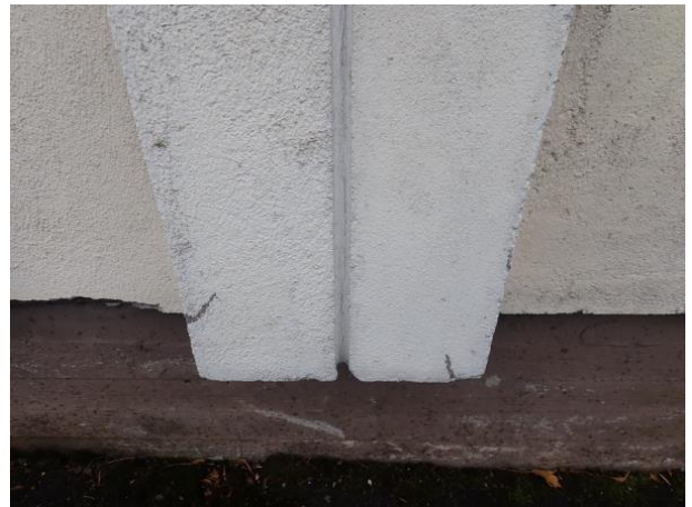
Kuva 10 Julkisivun saumamassa sisältää yli 1500 mg/kg lyijyä (aiempi tutkimus). Seinän ja sokkelin maaleissa ja tasoitteissa ei havaittu asbestia/haitta-aineita.
