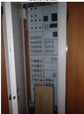
Kuva 5 Eteisen komerossa on vanha sähkötaulu.
